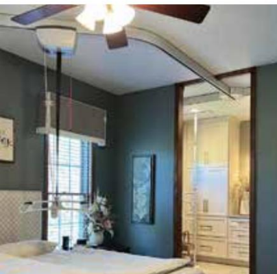
Amy Buren 社製 (LGMD R1/2A) のトラック システム付き天井リフトが天井に恒久的に設置されています。
